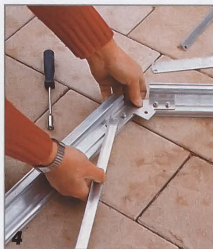
4 Сборка передней стенки. Здесь показано соединение углового элемента с угловой стойкой и торцевой связью.
