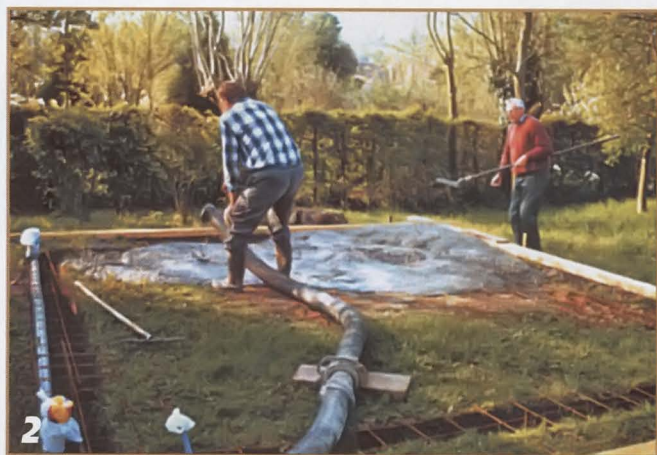
Предусмотрев необходимые инженерные вводы/выводы коммуникаций, после армирования траншеи и площадки бетонируют фундаментную плиту.
